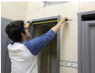
Figura 3. Puerta de Sanitario con 0.54 m de ancho.
